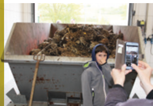
Von wegen Gestank: Dank moderner Technik sondert das Kitzinger Klärwerk kaum Geruch ab. Ausnahme: Die Behälter, in denen die Abfälle aus der Rechenanlage gesammelt werden.
