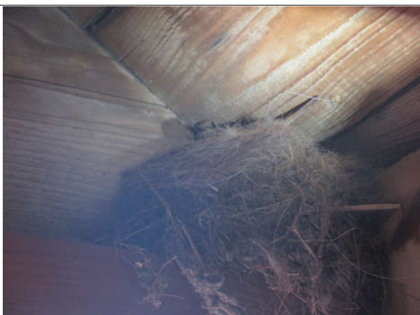
Foto 5: Besetztes Hausrotschwanznest über Fenster im Dachboden (Gebäude 8).
