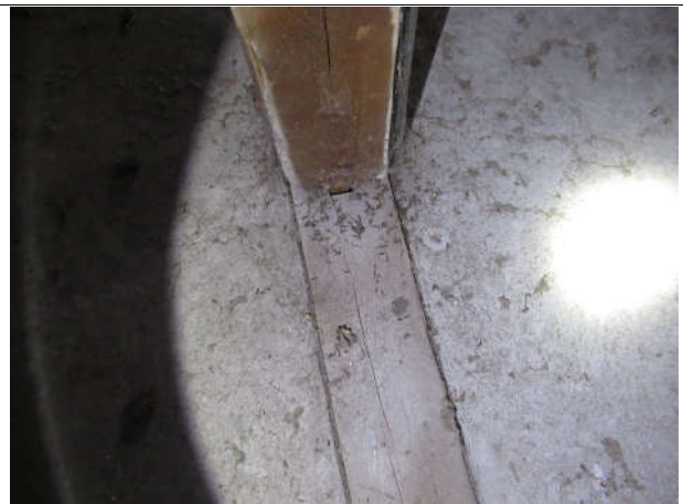
Foto 10: Fledermauskot unter Zapfloch im Dachboden, Gebäude 8
