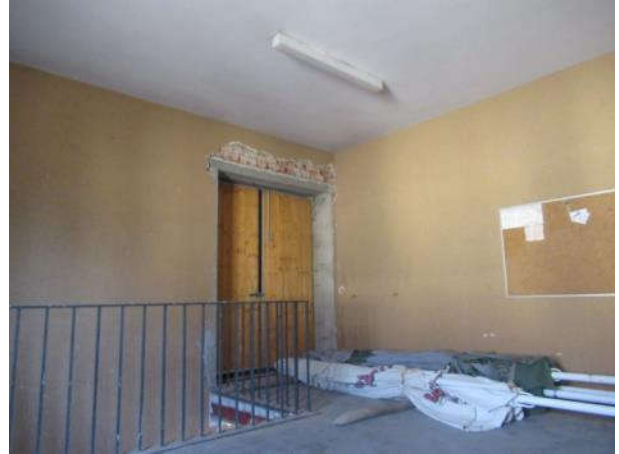
Foto 8: Spalten oberhalb der Türe mit darunter in geringer Menge liegendem Fledermauskot, Gebäude 9.
