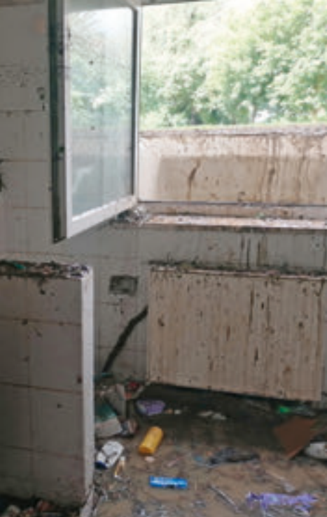
Schlamm und Dreck: Die Kellerwohnung in der Kaltensondheimer Straße ist für längere Zeit nicht bewohnbar.
