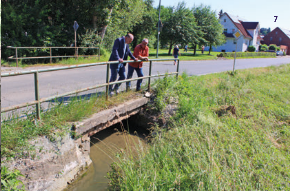
Klaus Wohlfeil und OB Stefan Güntner betrachten den Durchlass des Essbachs unterhalb der Kaltensondheimer Straße. An normalen Tagen fließt der Bach problemlos in seinem Bett – am 1./2. Juni verwandelte er sich in einen reißenden Strom.
